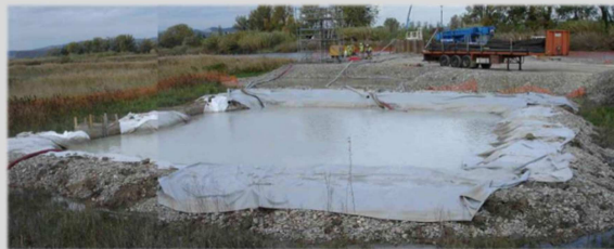
Figure 221 : Bassin provisoire de décantation des MES et autres polluants
